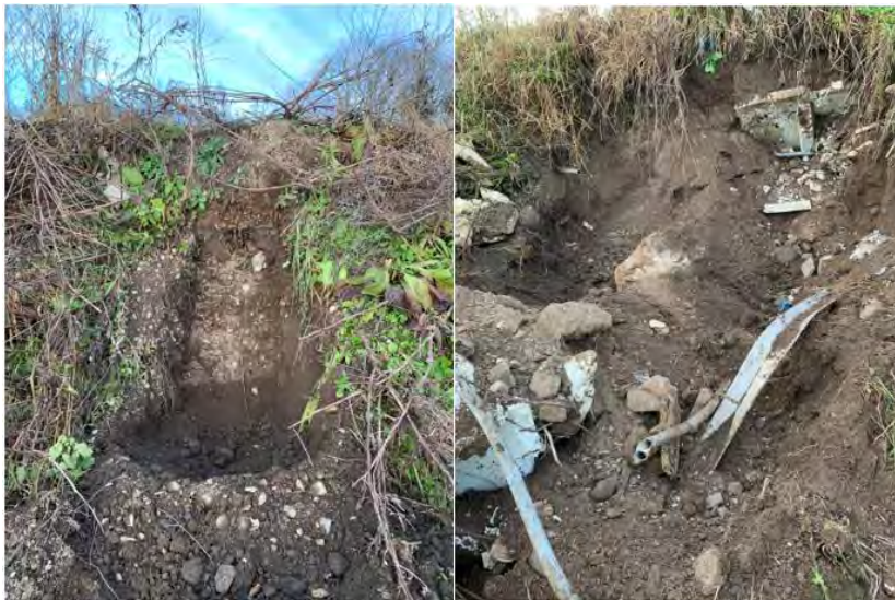
Figur 2.10 Foto av två provgropar i vallen. I provgropen på det högra foto var inslaget av avfall större än i provgropen på det vänstra fotot.
