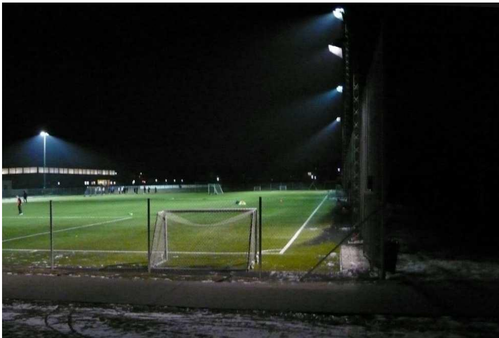
Bild 11 Specialtillverkad mekanisk avskärmning monterad på armatur skärmar av en stor del av ljuset som annars hade hamnat utanför planen.
