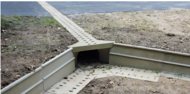
Figur 10. Groddjurspassage under väg med tillhörande fångstarmar som leder groddjuren mot tunnelöppningen. Foto: ACO
